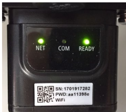
Figura 215 - Stato di comunicazione irregolare tra inverter e scheda
