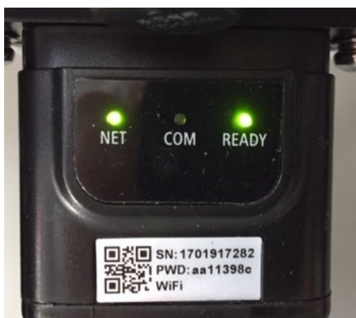
Figura 209 - Stato di comunicazione irregolare tra inverter e scheda
