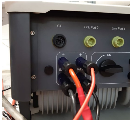
Figura 111 - Connessione potenza DC lato inverter con due ingressi batteria popolati
