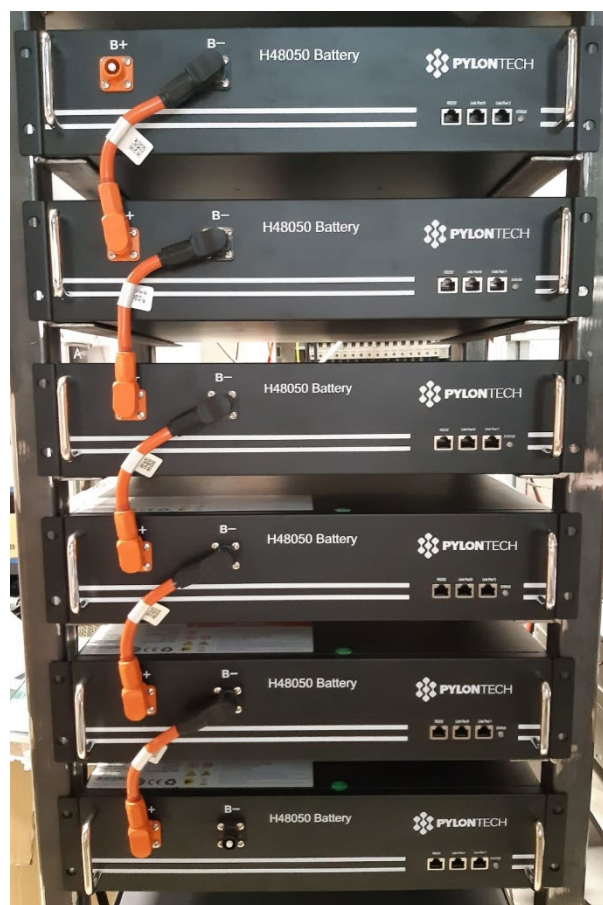
Figura 42 - Cablaggio potenza fra moduli batteria
