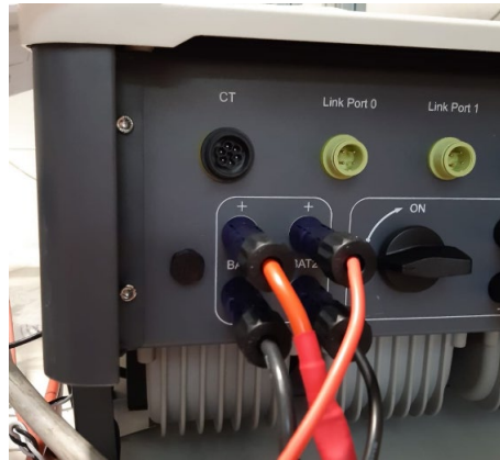
Figura 64 - Connessione potenza DC lato inverter con due ingressi batterie popolati
