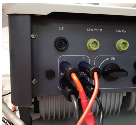
Figura 87 - Connessione potenza DC lato inverter con due ingressi batteria popolati
