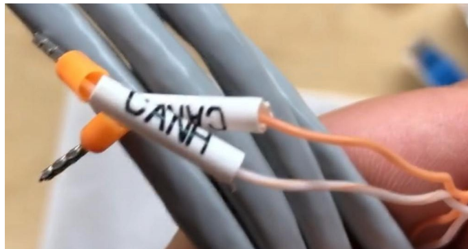
Figura 81 - Cavo comunicazione Inverter/HV BOX
