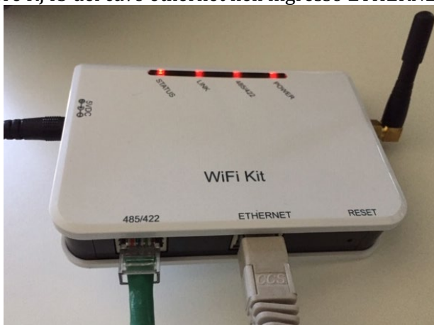
Figura 227 – Cavo ethernet connesso al datalogger
