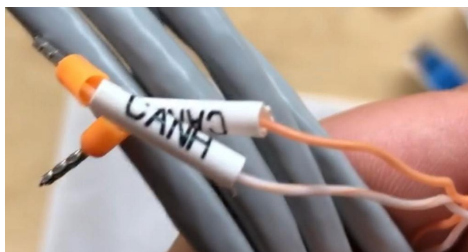
Figura 70 - Cavo comunicazione Inverter/HV BOX
