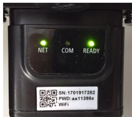
Figura 81 - Stato di comunicazione irregolare tra inverter e scheda
