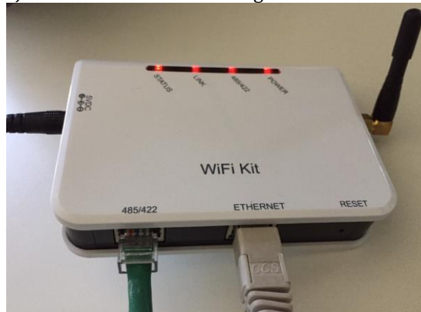
Figura 91 – Cavo ethernet connesso al datalogger
