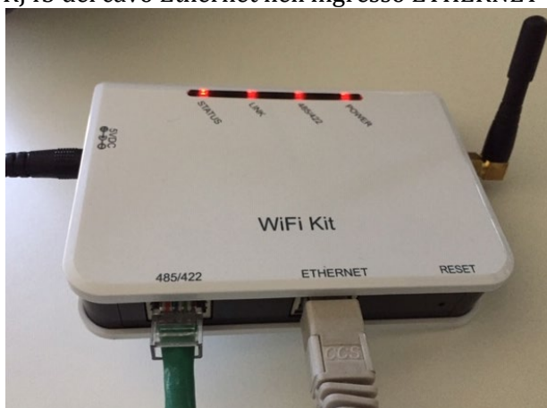
Figura 89 – Cavo Ethernet collegato al datalogger
