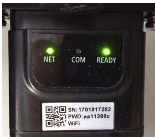
Figura 66 - Stato di comunicazione irregolare tra l'inverter e l'adattatore
