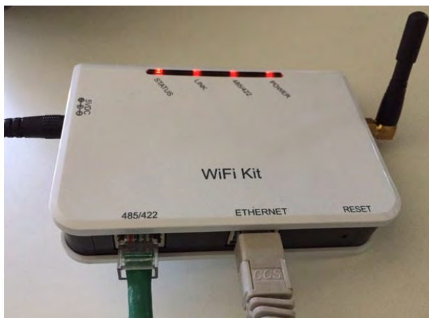
Figura 92 - Cavo Ethernet collegato al datalogger
