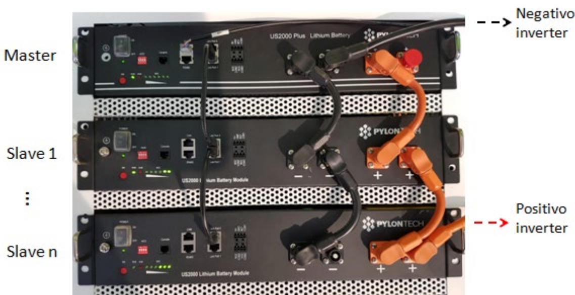
Figura 11 - Parallelo di tre batterie Pylontech
