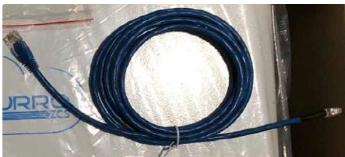
Figura 29 - Cavo di comunicazione fra inverter e batteria WeCo 5k3
