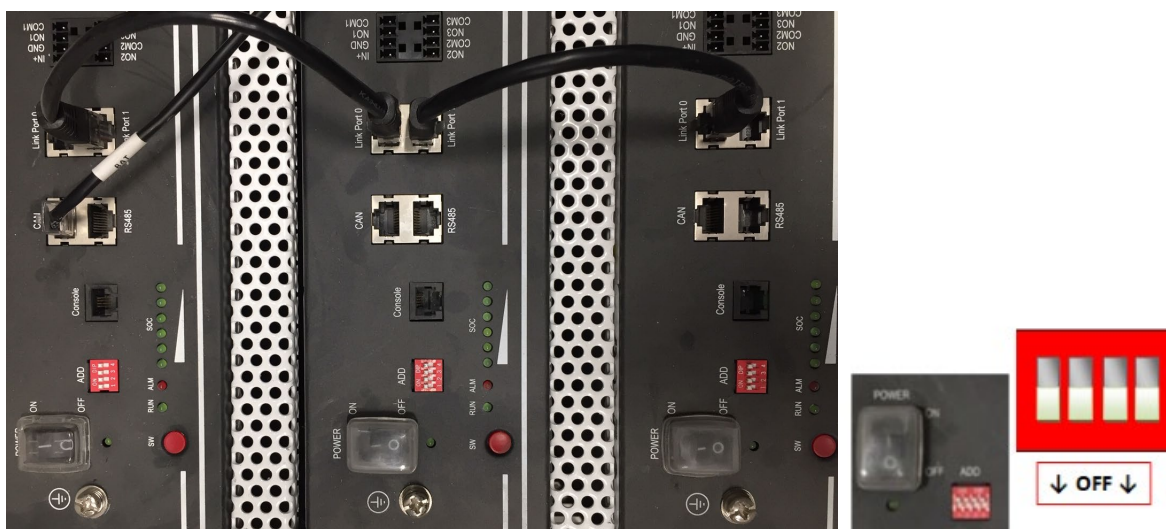
Figura 14 - Connessione di comunicazione tra tre batterie Pylontech
