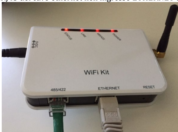
Figura 136 – Cavo ethernet connesso al datalogger
