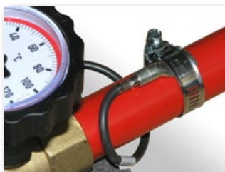
Figura 5: Collegamento della sonda a contatto sulla mandata
